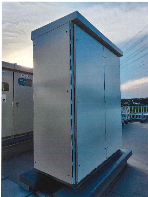
蓄電設備 5.6 kW*2=11.2KW 停電時4KW
